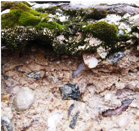
Obr. 5 Degradovaný beton. V důsledku synergického působení vlhkosti a mrazu došlo k narušení povrchových vrstev betonu – jsou odhalena zrna hrubé frakce kameniva. Dalším negativním fenoménem je pak působení oxidu uhličitého – karbonatace.
