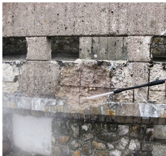
Obr. 8 K finálnímu dočištění povrchu je možno využít vysokotlaký vodní paprsek, přičemž pracovní tlak je třeba korigovat s ohledem na pevnostní charakteristiky obnovovaného (soudžnost) betonu.
